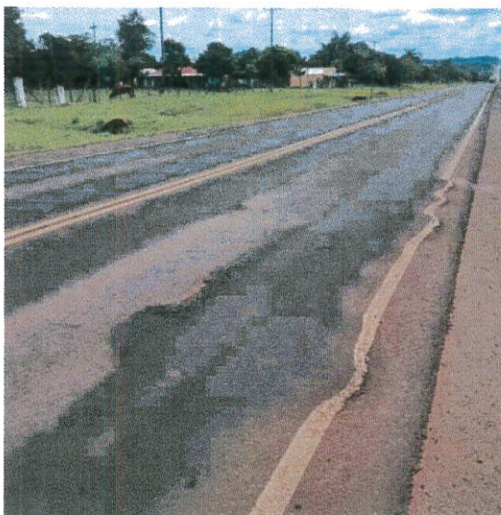
Km 173 - Carril descendente Deformaciones transversales y desplazamientos (baches) de borde
