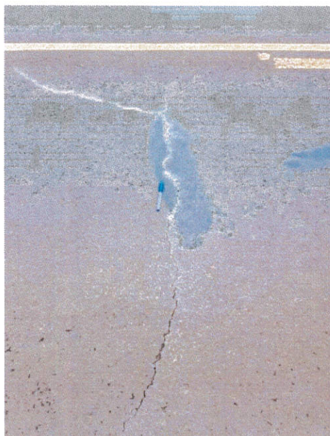
Km 278 - Carril descendente Fisuración transversal
