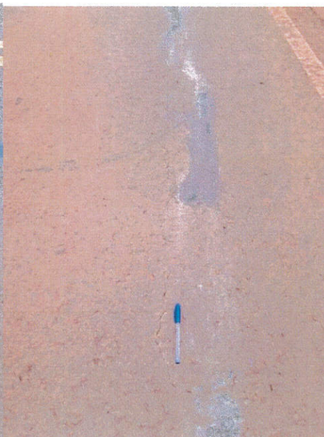
Km 336 - Carril descendente Fisuración longitudinal en la huella
