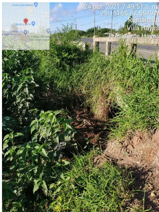
Foto 29. Vegetación enraizada que cubre el canal de drenaje.
