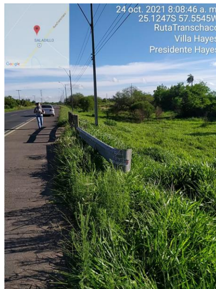
Foto 33. Gramíneas y malezas, canal de drenaje taponado.
