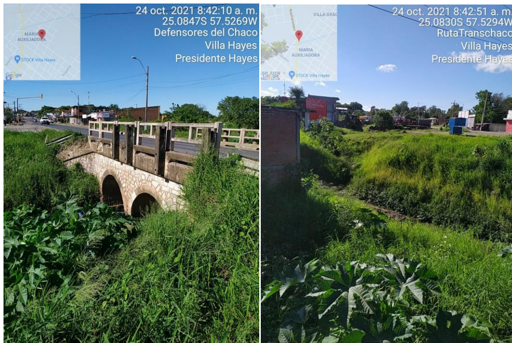
Foto 61 y 62. Puente con alcantarilla, cubierta con malezas y vegetación acuática enraizada.
