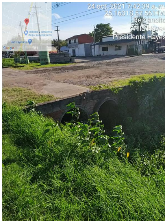
Foto 26. Alcantarillado cubierto por malezas y plantas acuáticas enraizadas.
