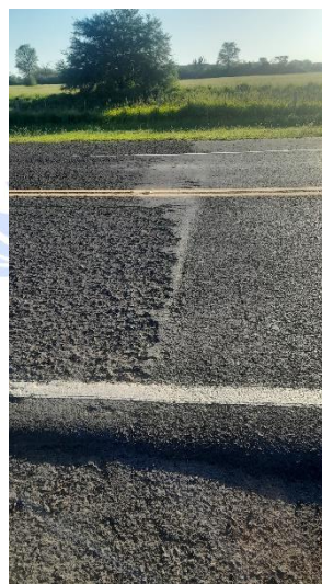
Fotografía N° 12: Diferencia entre pavimento con mantenimiento y sin él.
