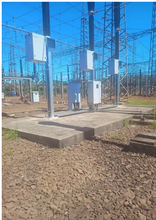
Fotografía N° 16 : Transformadores colocados SE Acaray
