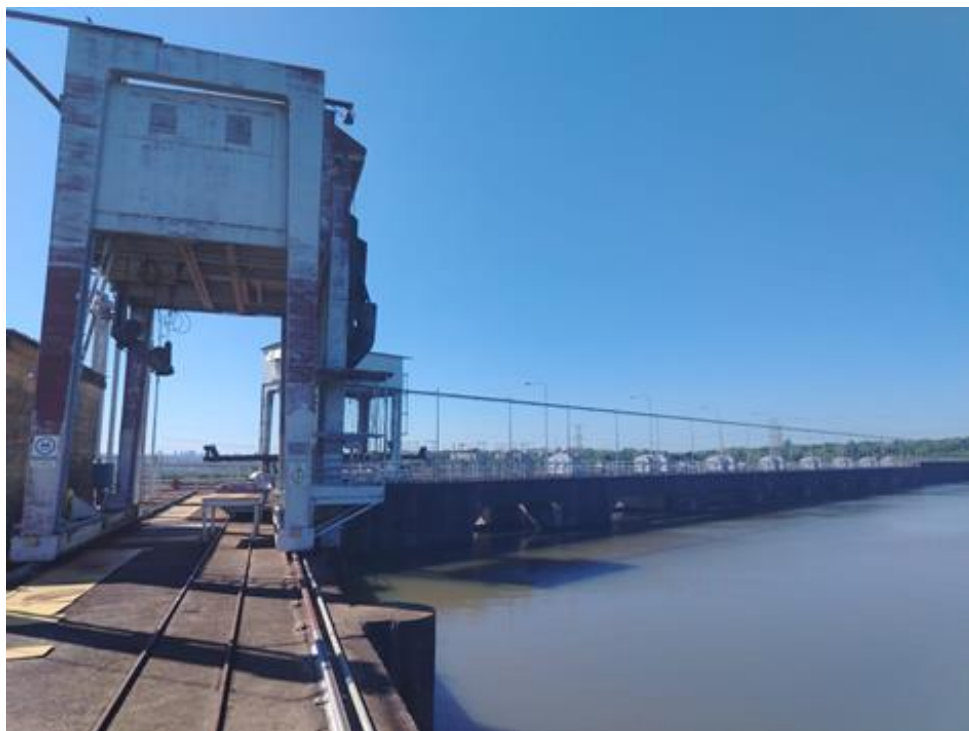
Fotografía N° 6: Pórtico grúa, compuertas y equipos hidromecánicos a ser modernizados Represa Acaray
