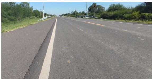
Fotografía N° 4: Estado actual de un tramo del Acceso a Filadelfia
