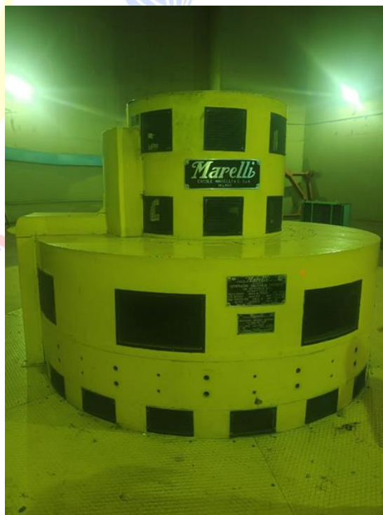
Fotografía N° 8: Equipo generador de Energía C.H. Acaray
