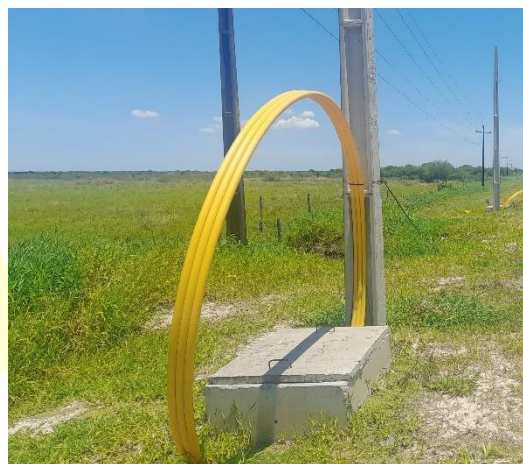
Fotografía N° 2: Registro con cableado para fibra óptica
