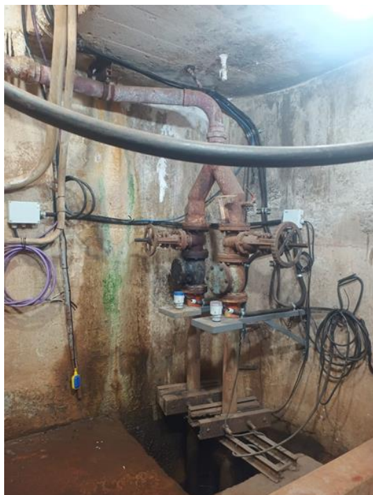
Fotografía N° 12: Cámara de estación de bombeo – Represa Acaray
