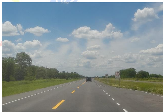
Fotografía N° 4: Estado actual de parte del tramo y banquina
