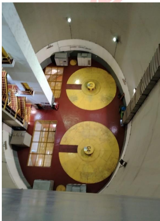
Fotografía N° 7: Sala de turbinas C.H. Acaray
