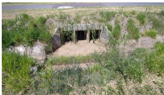
Fotografía N° 3: Alcantarillas celulares en el marco del proyecto.
