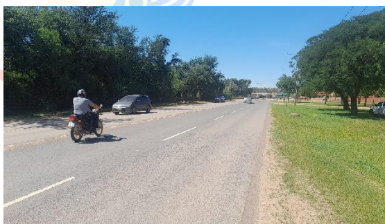
Fotografía N° 8: Estado actual de parte del tramo acceso a Neuland
